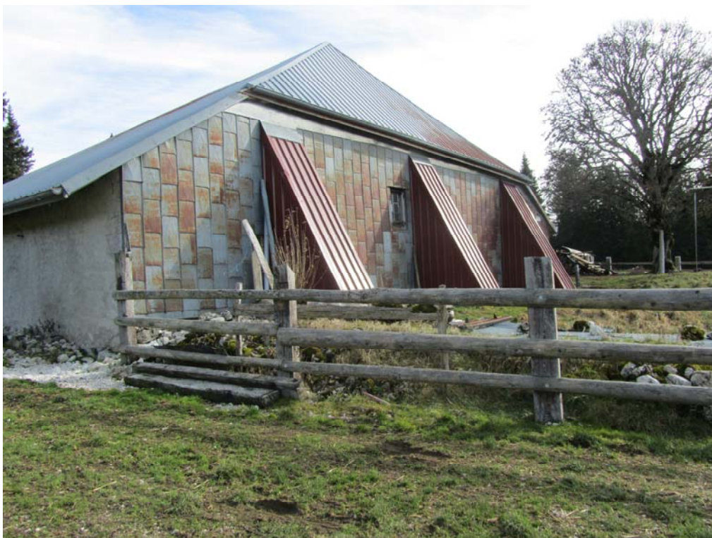
Les contreforts vraiment bizarres, et très peu esthétiques, du pignon côté pâturage. Avec le rouge des tôles profilées, à distance, on ne voit que cela et l'on s'interroge.
